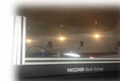
アイルシャッター (エアフロア隔壁)
