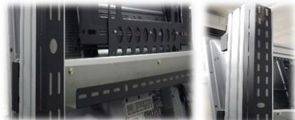
ケーブルマネジメント
