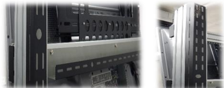
ケーブルマネジメント
