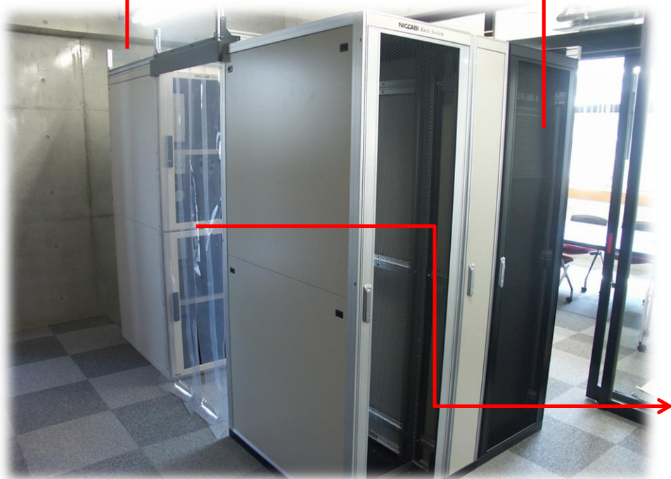
アイル出入り口モジュール
